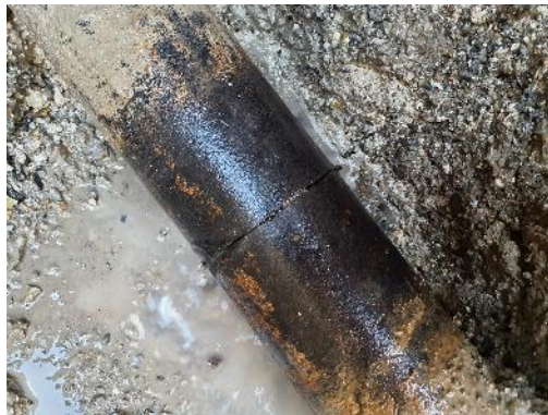
Fuite sur canalisation route de Vaux à Corbie
